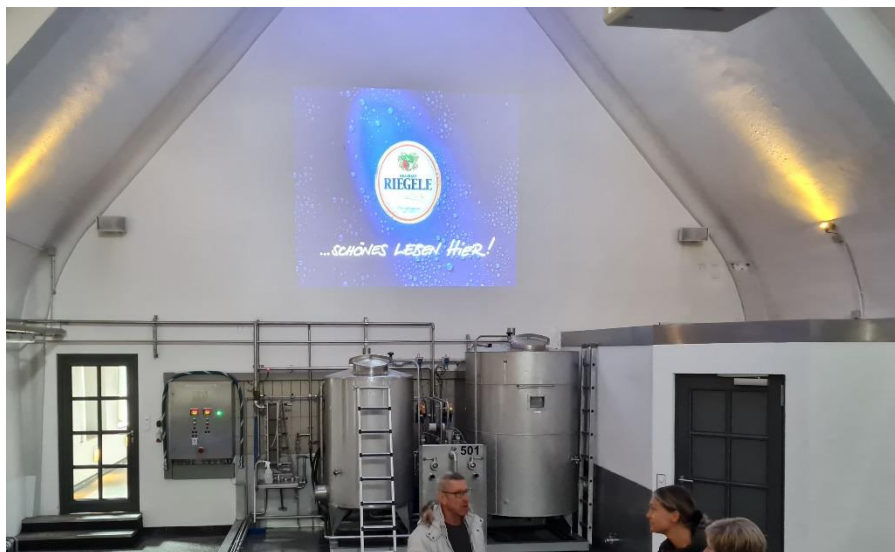
Start der Führung unter dem Dach bei den Heißwassertanks und mit dem Imagefilm
